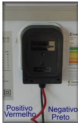
Figura 34 - Identificação dos cabos atrás do painel fotovoltaico
